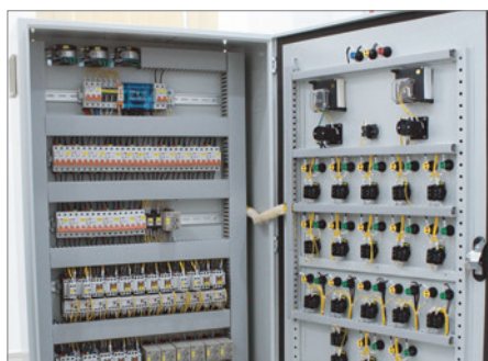
Tủ điện điều khiển xử lý môi trường
