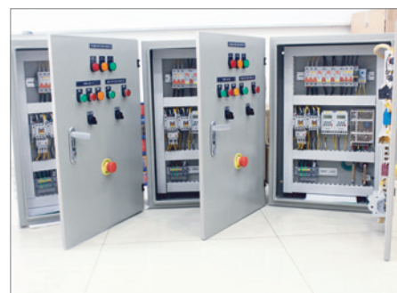
Tủ điện điều khiển hồ bơi
